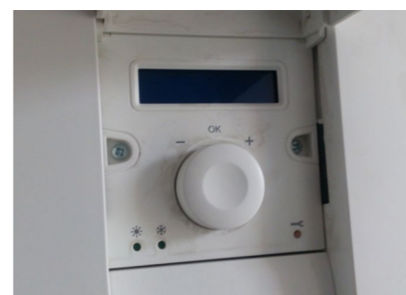
Ovládání vzduchotechnické jednotky zdroj: EkoWATT
