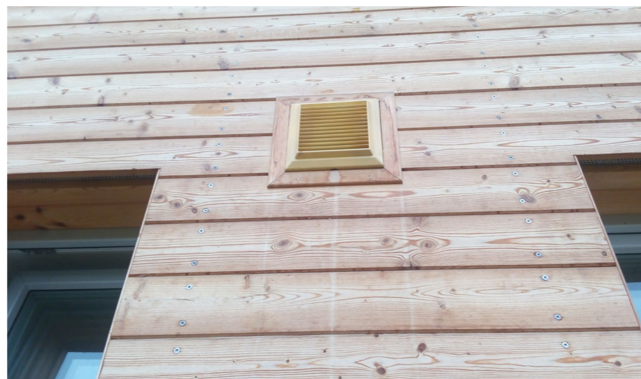
Výdech z vzduchotechnické jednotky na fasádě, zdroj: EkoWATT
