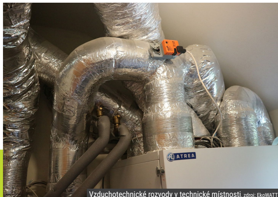
Vzduchotechnické rozvody v technické místnosti, zdroj: EkoWATT
