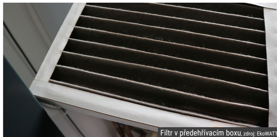
Předehřev, zdroj: EkoWATT
