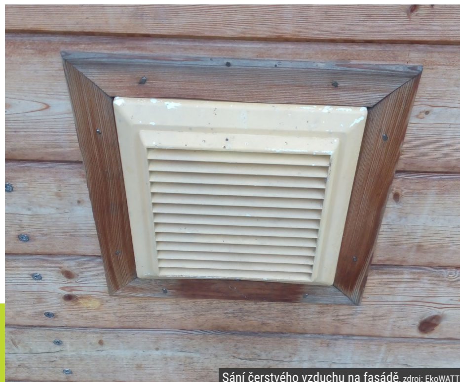
Sání čerstvého vzduchu na fasádě, zdroj: EkoWATT
