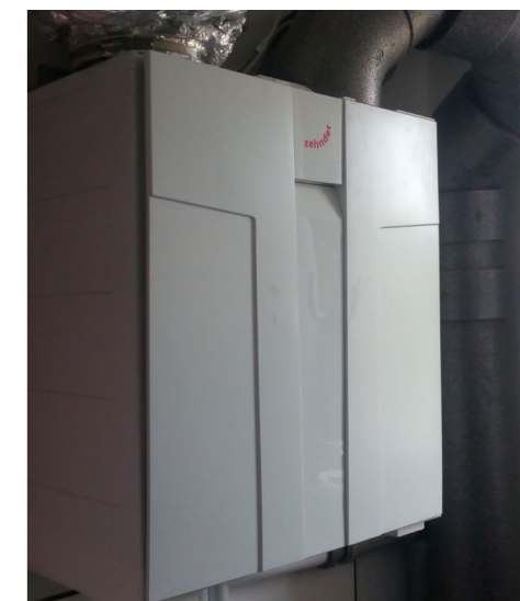
Rekuperační jednotka v technické místnosti, zdroj: EkoWATT
