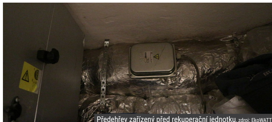
Přehřev zařízení před rekuperační jednotku, zdroj: EkoWATT
