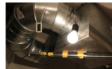
Tlumič hluku na vzduchotechnickém potrubí, zdroj: EkoWATT
