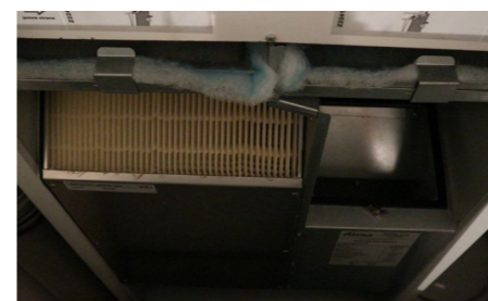
Pohled do vzduchotechnické jednotky, zdroj: EkoWATT
