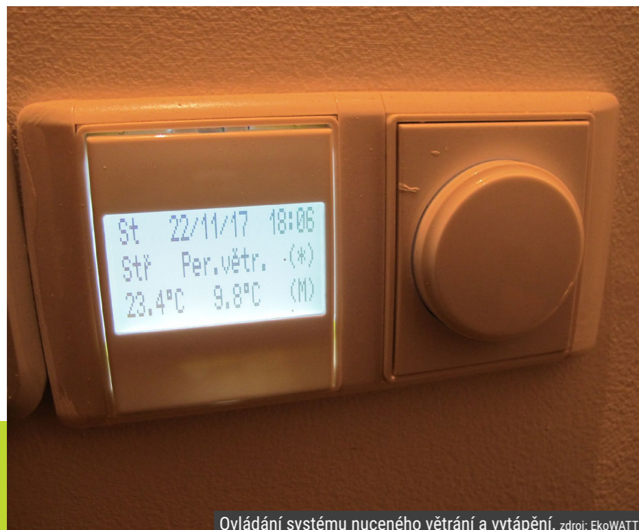
Ovládání systému nuceného větrání a vytápění, zdroj: EkoWATT
