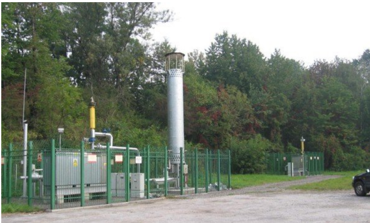
Obrázek - Odsávací stanice důlního plynu
