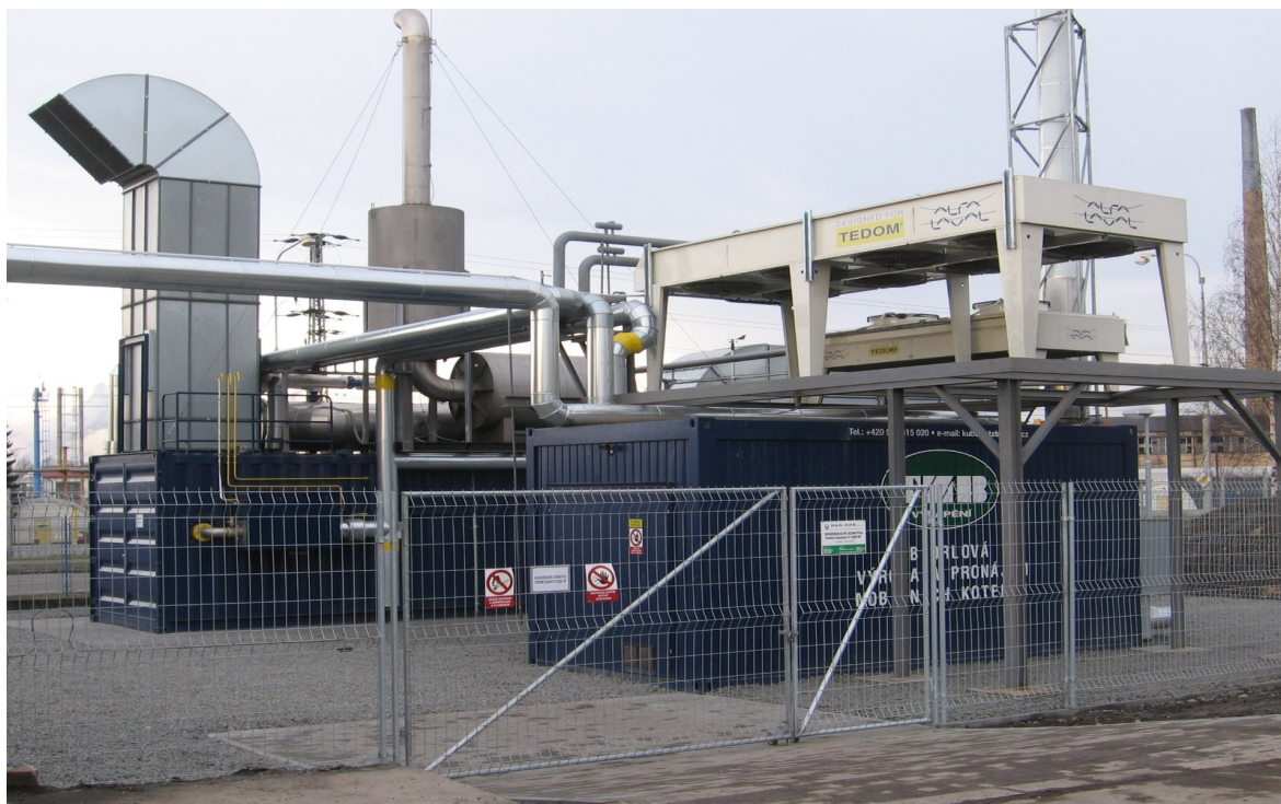
Kogenerační jednotka Muglinov a záložní plynový kotel
