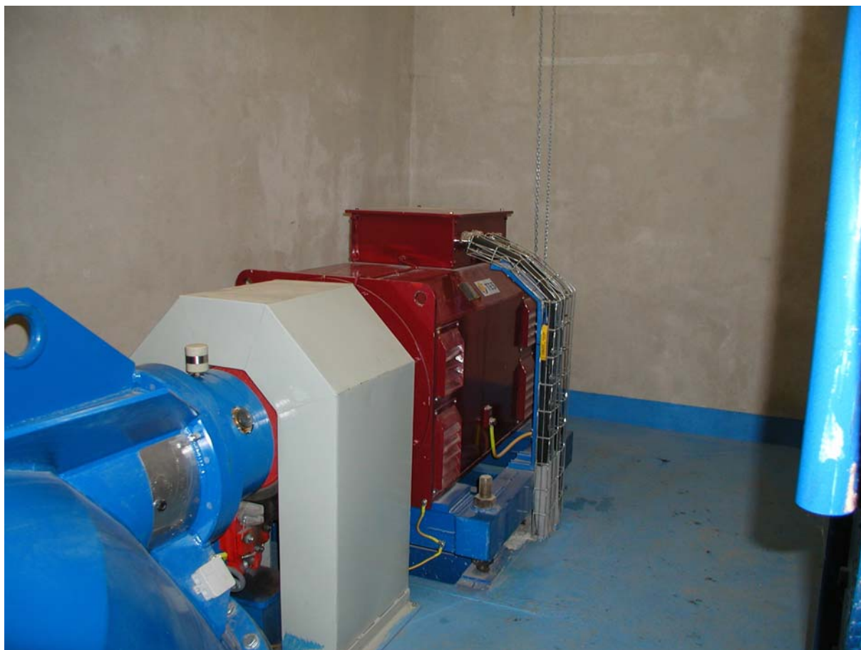
Pohled na instalované soustrojí
