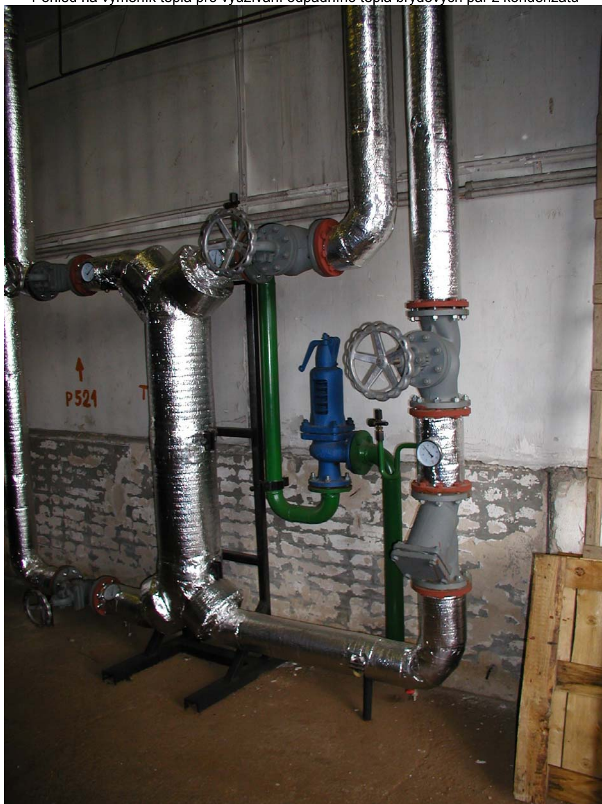
Pohled na výměník tepla pro využívání odpadního tepla brýdových par z kondenzátu
