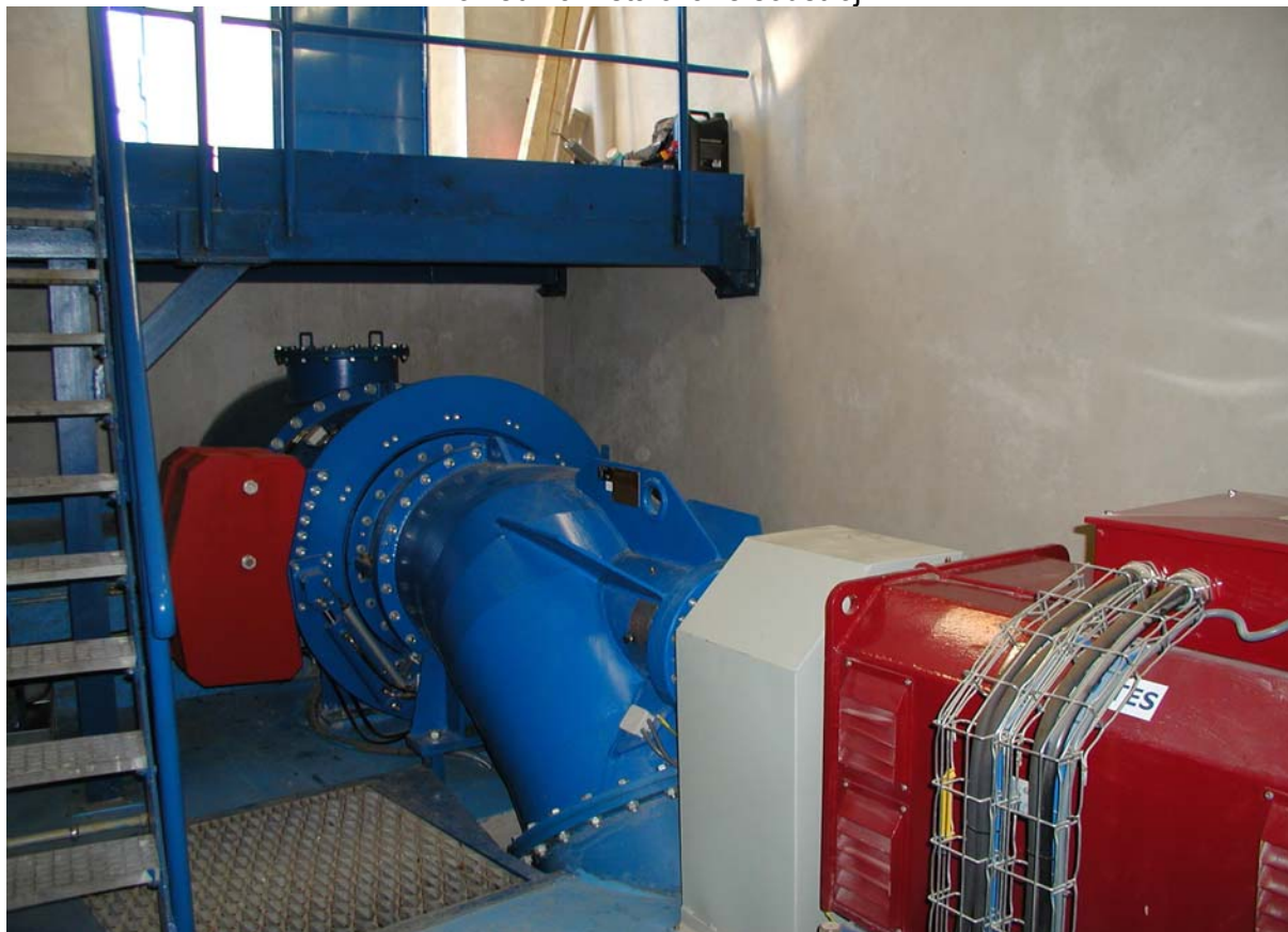
Pohled na instalované soustrojí
