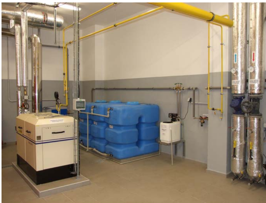
Instalovaná malá KJ Tedom s úpravnou vody
