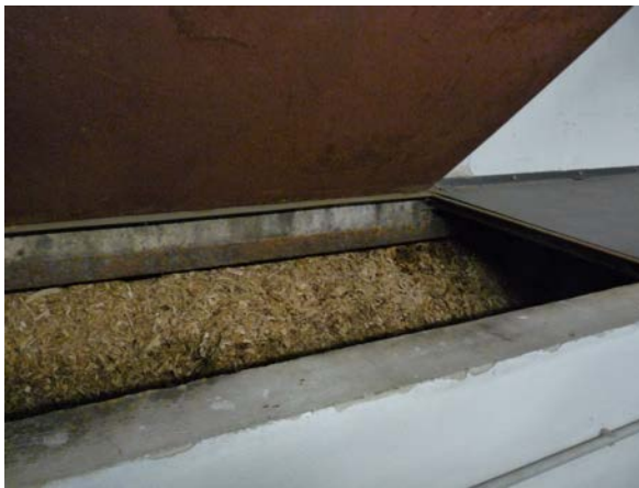
Obrázek 22 - doprava paliva ke kotli
