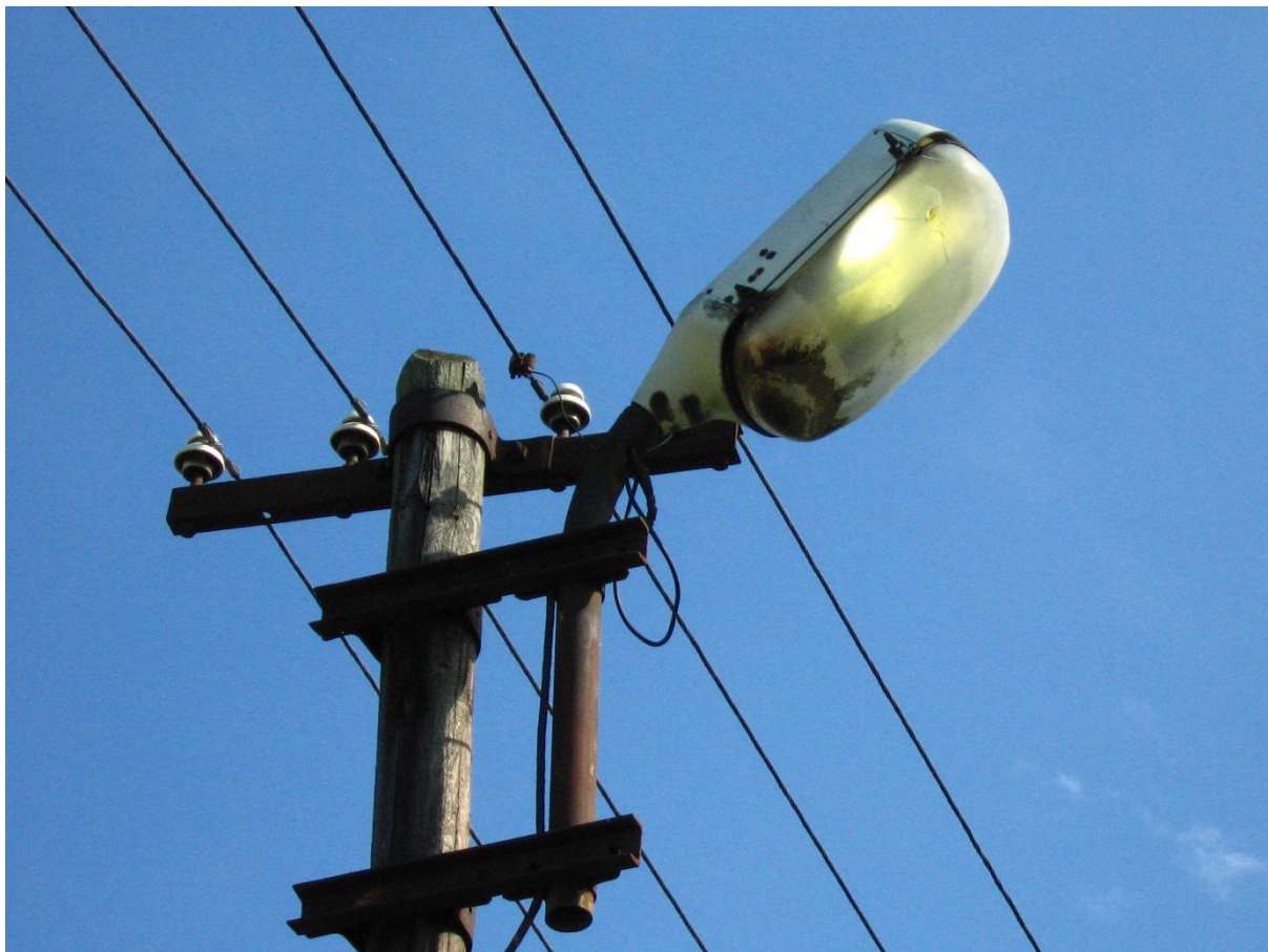
Obrázek 28 Nehospodárné řešení provozu dosluhujícího VO v okrajové části malé obce. Příkon svítidla 270 W spolu s malým měrným výkonem rtuťové výbojky a po 50 letech provozu již s minimální účinností opticky aktivních ploch je toto svítidlo zcela nevyhovující (foto: Theodor Terrich)
