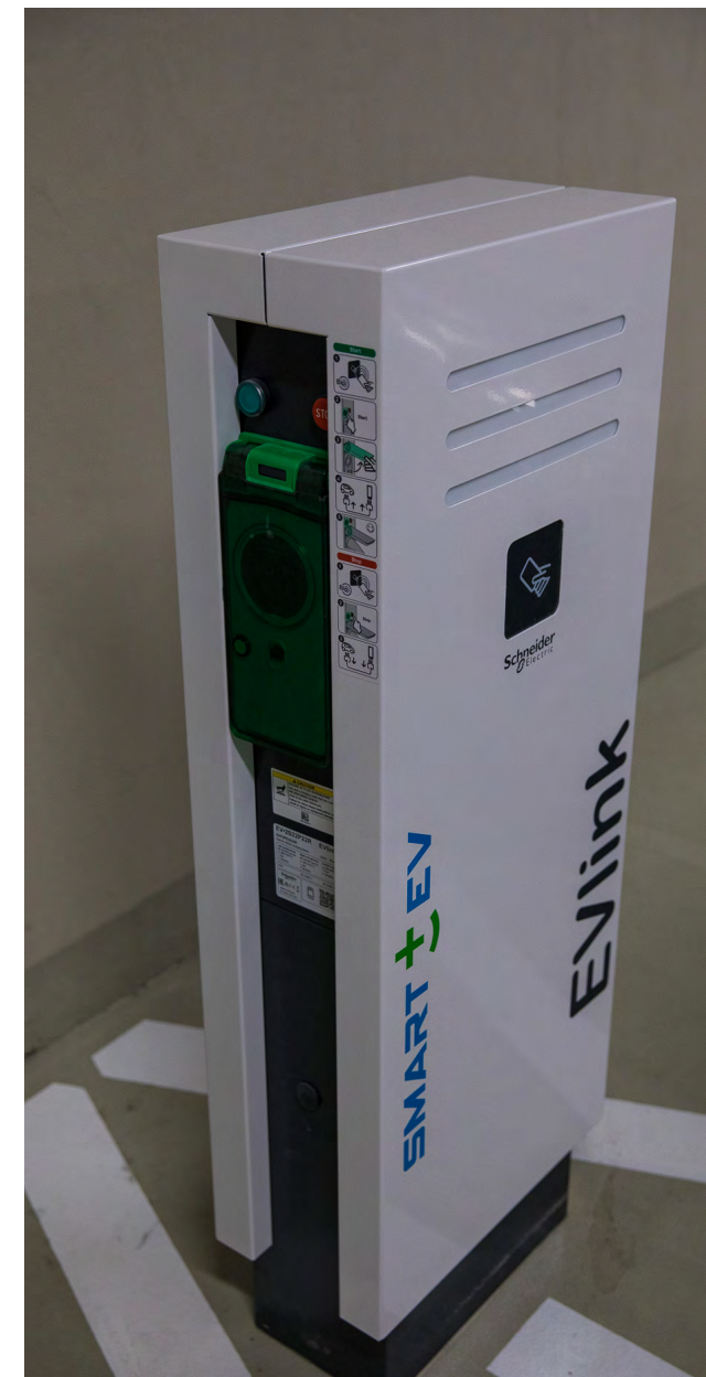
Kancelářská budova Green Point v Praze-Smíchov - dobíjecí stanice pro elektromobily (Zdroj: CZGBC)
