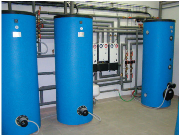
Obr. 2 – Vnitřní instalace zásobníků teplé vody WPS 500 a akumulčního zásobníku PSP 500
