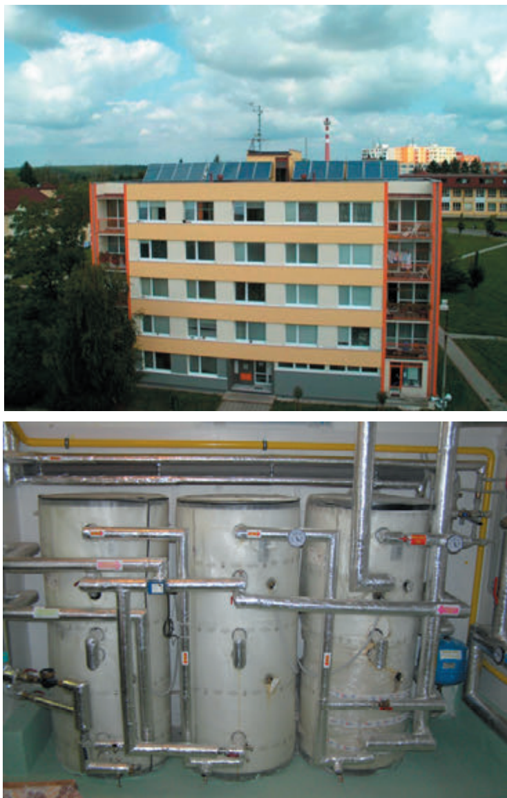
Obr. 2 – Ukázka realizace solární soustavy pro přípravu teplé vody v bytovém domě
