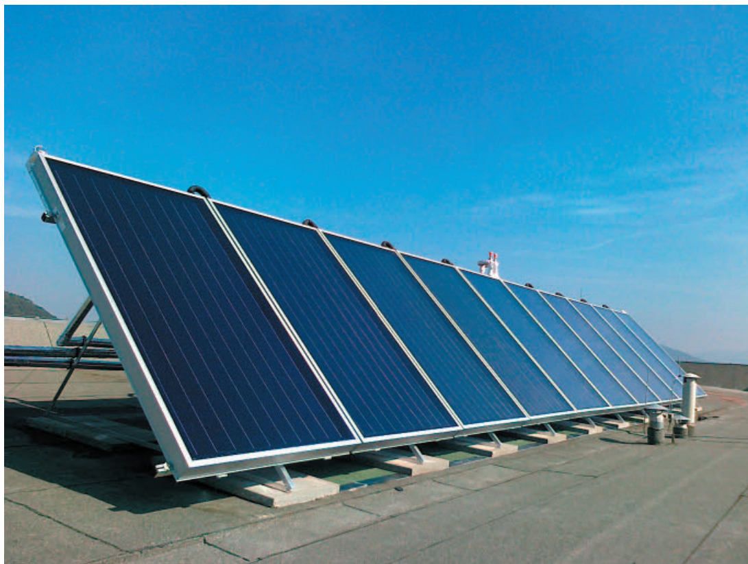
Obr. 1 – Solární systém pro přípravu teplé vody
