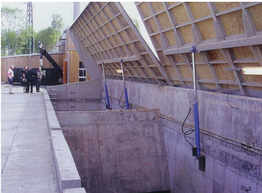
Podzemní zásobník paliva s hydraulicky uzavíratelnými poklopy
