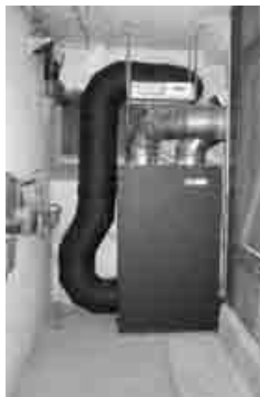
Bild 2 Lüftungsgerät mit WRG
