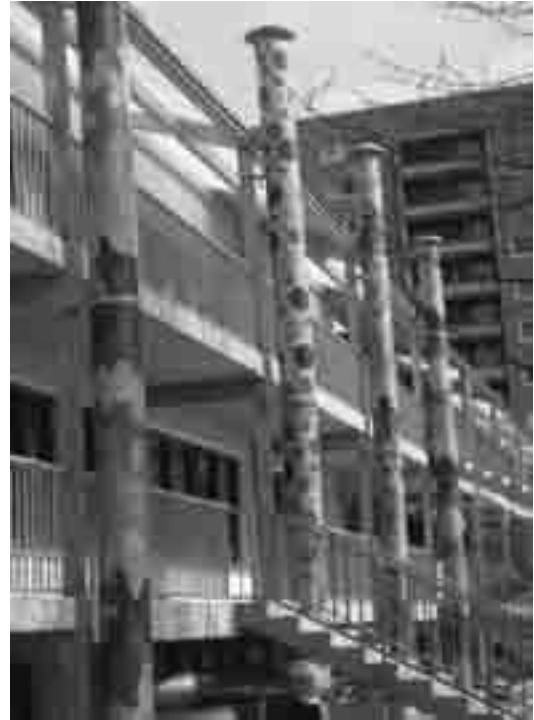
Obr. 10 Potrubí na odpadní vzduch
