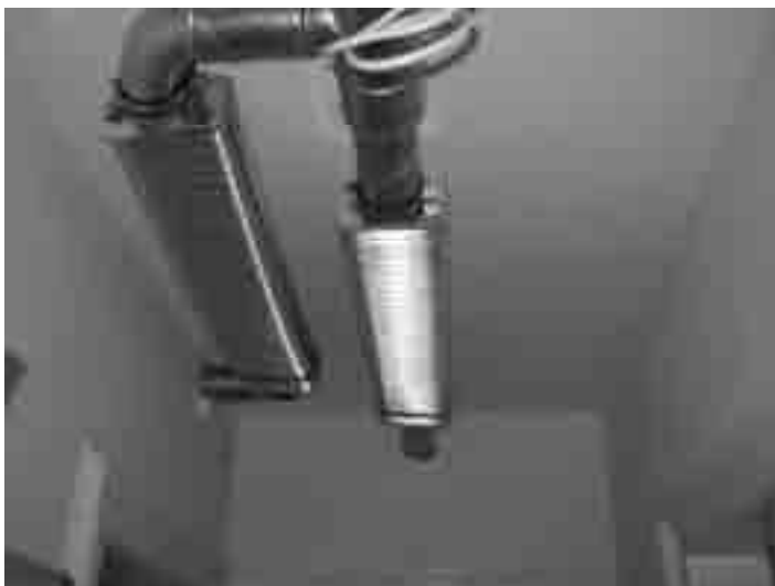
Obr. 7 Tlumič na chodbě k bytové jednotce
