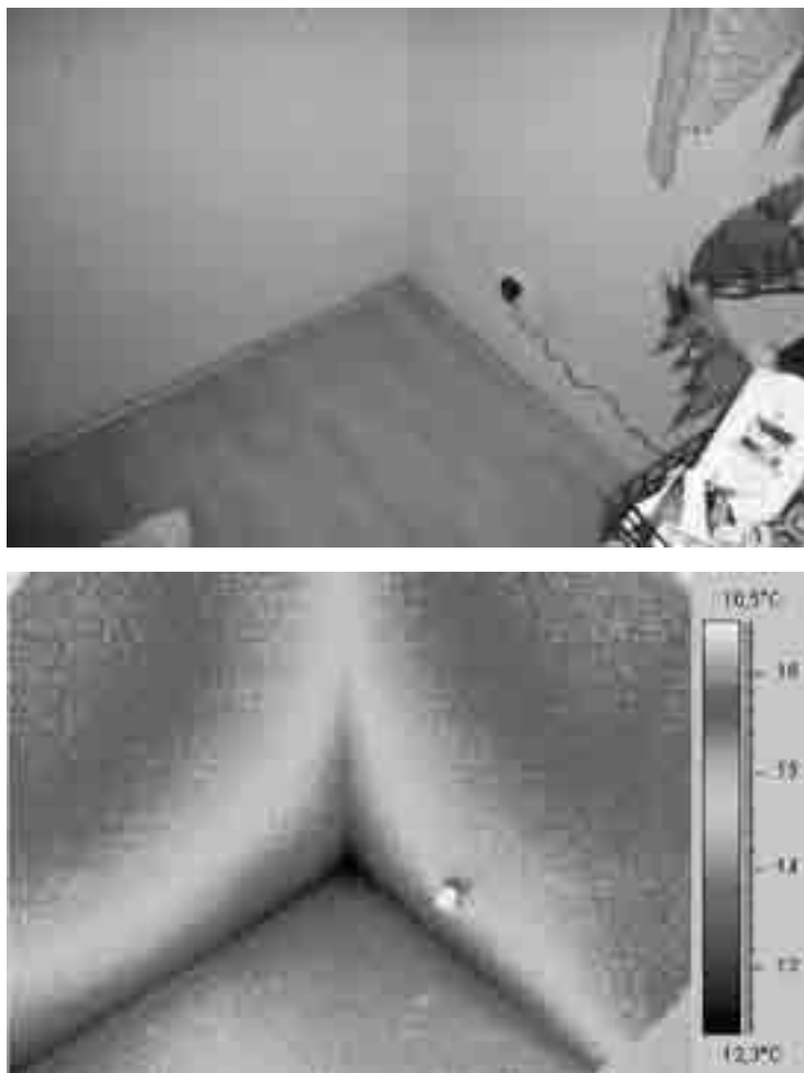
Obr. 5 Pohled na termogram vnitřních stěn v zimním období – snížená teplota povrchu
