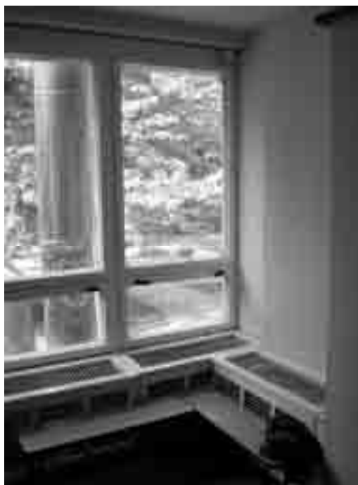
Obr. 2 Detailní pohled před sanací
