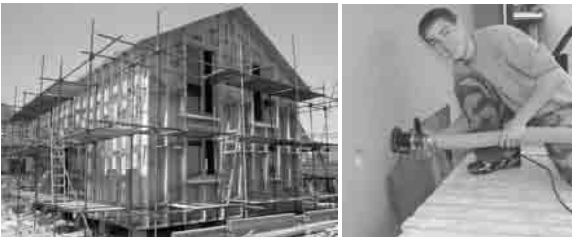
Obr.7. Oddělování komor v konstrukci před foukáním izolace na požadovanou hustotu a aplikace
