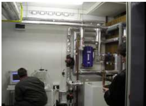
Obrázek 11: Strojovna solárního ohřevu
