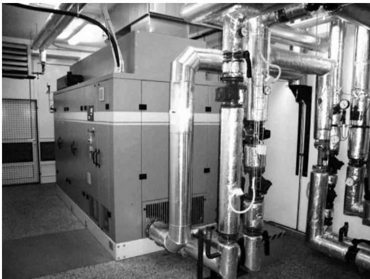
Obr. 43 Spalovací motor v kogeneračním zapojení v objektech firmy TEDOM Třebíč
