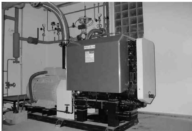
Obr. 14 Pohled na soustrojí parního motoru s elektrickým generátorem (Polycomp)
