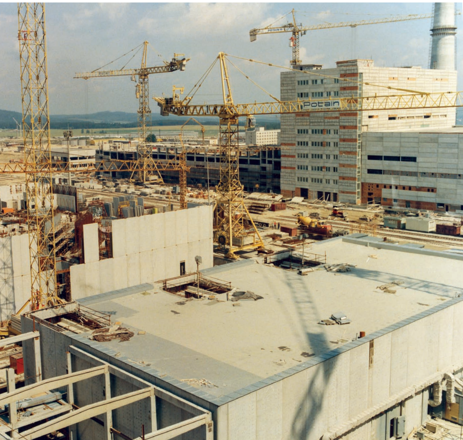
KOMPRESOROVÁ A ČERPACÍ STANICE, V POZADÍ BUDOVA POMOCNÝCH PROVOZŮ THE COMPRESSOR AND PUMP STATION, IN THE BACK THE BUILDING OF ANCILLARY SYSTEMS
