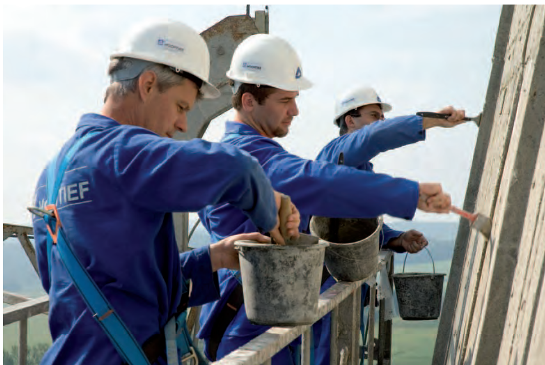
PROVÁDĚNÍ OCHRANNÉHO NÁTĚRU CHLADICÍCH VĚŽÍ PUTTING THE PROTECTIVE PAINT ON THE COOLING TOWERS
