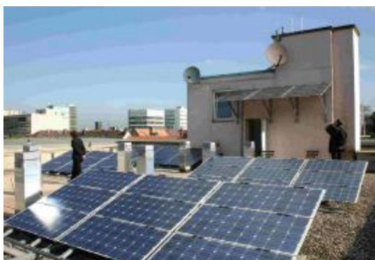
Obrázek 23: Fotovoltaické panely na šikmé a na ploché střeše.
