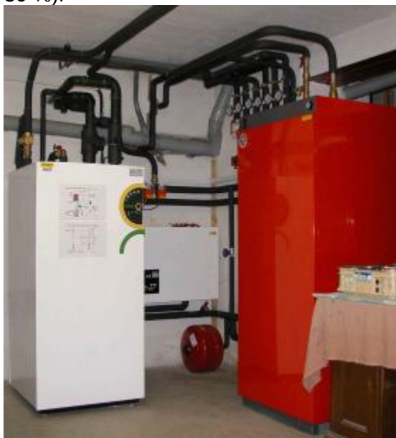
Obrázek 56: Kotelna s 20 kW TČ (Foto: Alterm s.r.o.)
