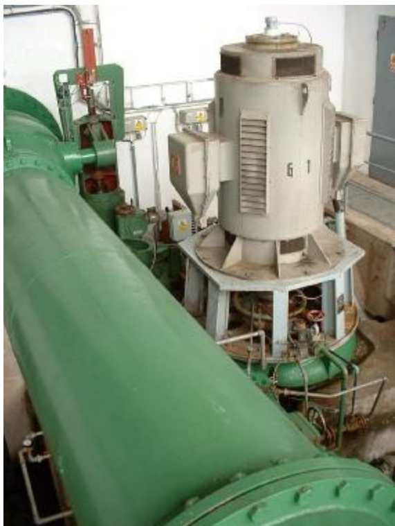
Obrázek 31: Turbína s generátorem na přivaděči v úpravně pitné vody nahradí škrticí armatury.
