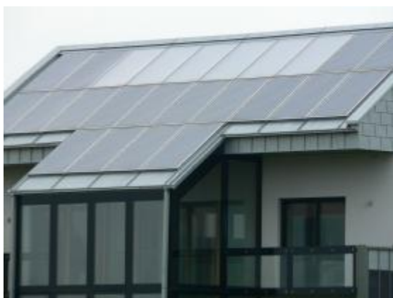
Obrázek 19: Fotovoltaické panely v kombinaci s teplovodním systémem tvoří krytinu střechy
