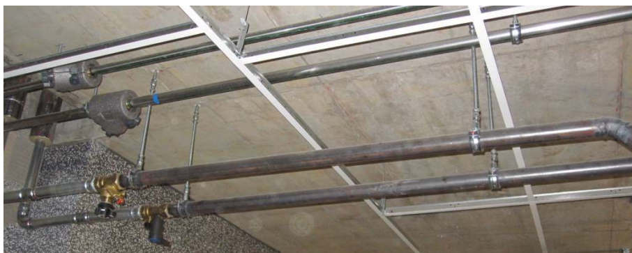
Obrázek 7 Rozvod studené vody v tepelné obálce, rozvod topné vody pod ní
