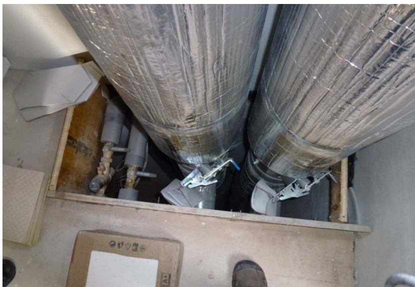
Obr. 5 Prostup páteřních stoupaček VZT stropní deskou. Podlaha tvoří předěl mezi byty v podlaží nad sebou. Místo převažujících netěsností při blower-door testu typu „B“.
