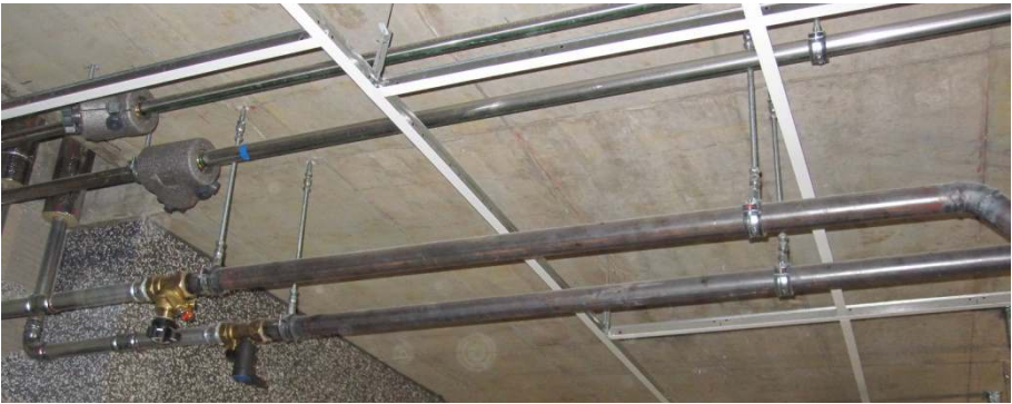
Abbildung 7 Kaltwasserleitung in, Heizleitungen unterhalb der thermischen Hülle
