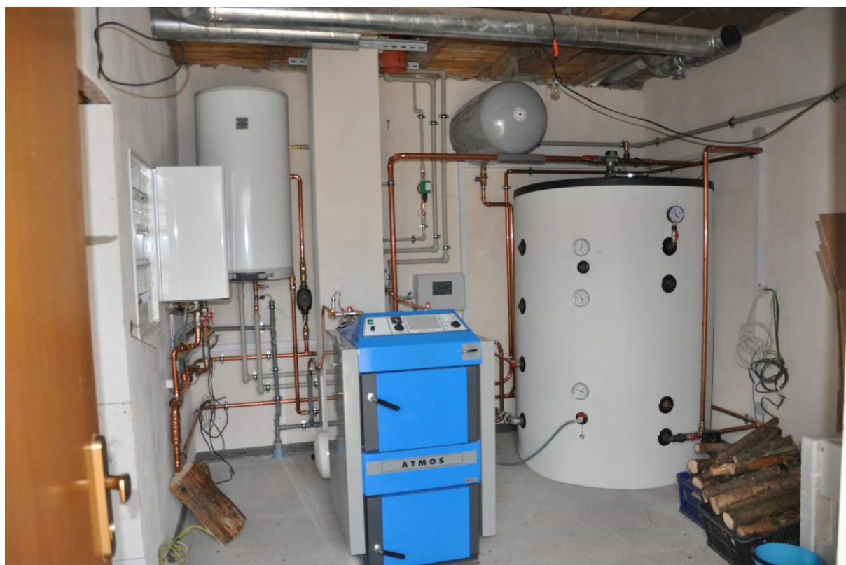
Obrázek 22 Pohled do technické místnosti rodinného domu; všechny technické systémy jsou soustředěny zde včetně elektrického rozvaděče (foto: PORSENNA o.p.s.)
