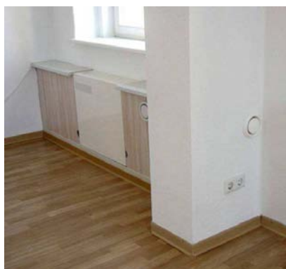
Obr. Efektivní větrání prostor lze zabezpečit i decentrálními jednotky. Zvláště výhodné pro větrání malých prostor, nebo rekonstruovaných objektů. Umístění jednotky je zde řešeno jednoduchým způsobem s malými nároky na prostor a s minimálním počtem a délkou rozvodů.
