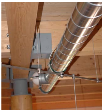
Obr.10 V některých případech i přiznané rozvody vzducho-techniky mohou vypadat v interiéru přirozeně.
