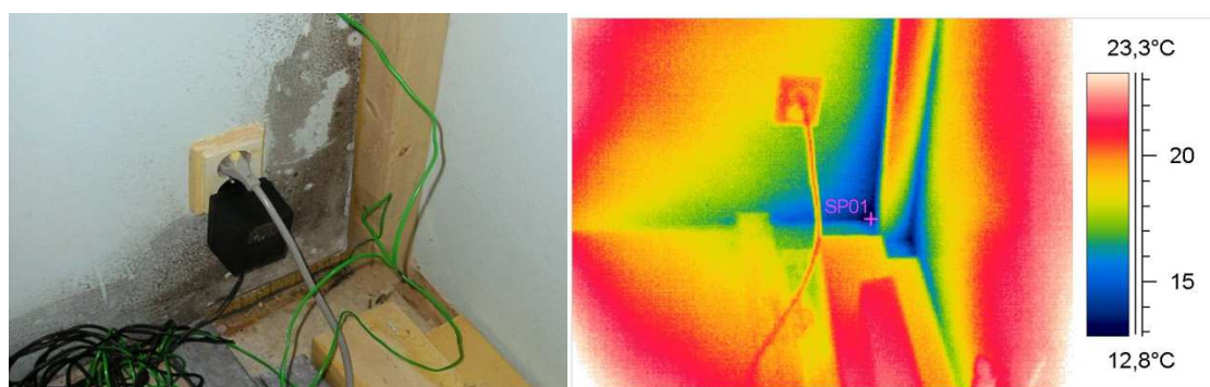
Obr. 7.19 Ukázka projevu plísní v koutě u základů nezatepleného objektu
