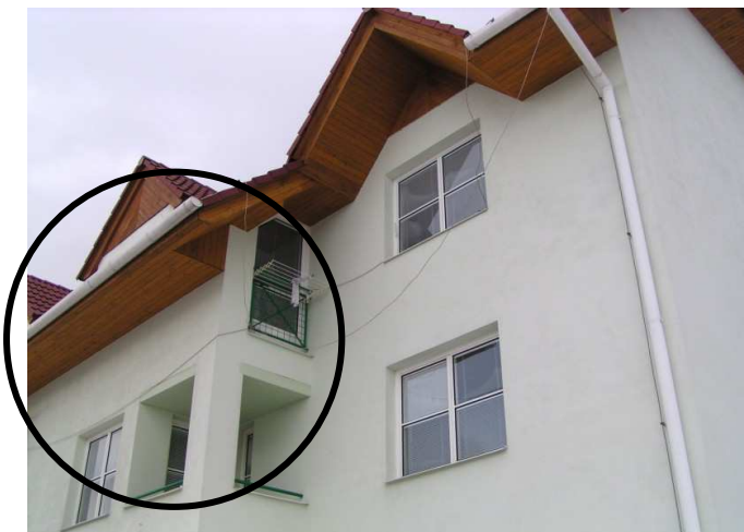
Obr. 7.22 Pohled na francouzské okno a problematický detail
