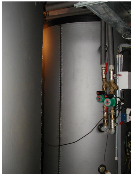
Obrázek 34: Zásobník teplé vody. Zdroj: EkoWATT.
