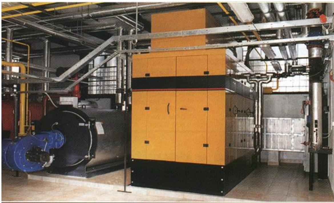
Obr. 9 KVET s plynovým motorem v protihlukovém krytu
