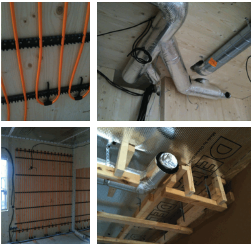
Obr. 3 Rozvody stěnového topení a vzduchotechniky.
