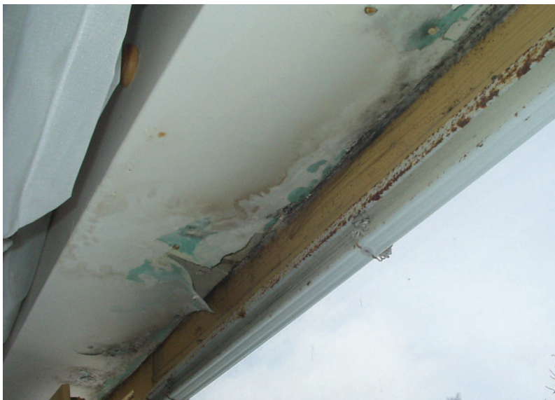
Obr. 2 Interiér jednoho z bytů kolonky Rudník v Podkrkonoší, architekti při návrhu a realizaci nerespektovali elementární zásady stavební fyziky a stavitelství. Stavba obdržela cenu Grand prix v roce 2001, dodnes není pro četné vady zkolaudována (jeden z prvních pomníčků české moderní architektury). Foto: Awal.
