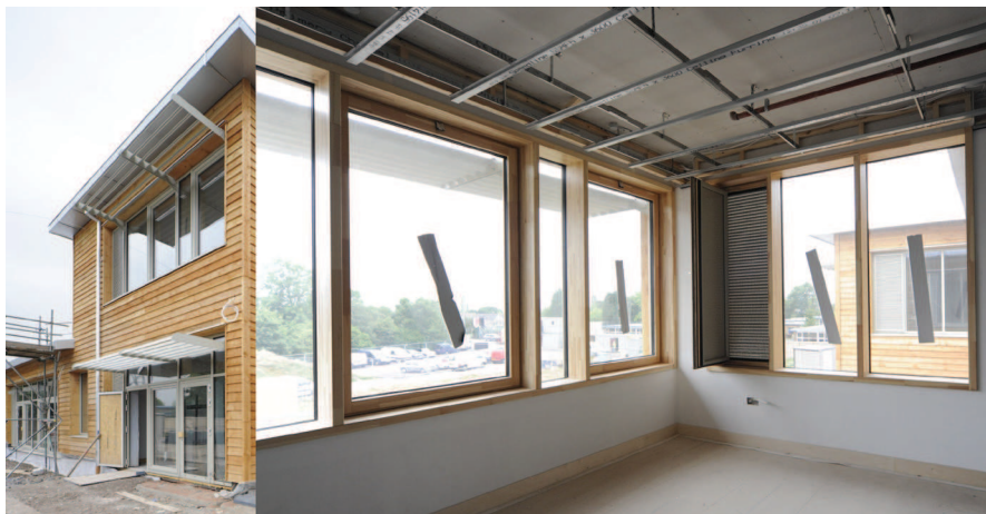
Obr. 9 Základná škola Oakmeadow: pohľad do triedy - fixné zasklenia, veľké otváracie automatickými otváračmi osadené krídla a bezpečnostné žalúzie pre zabezpečenie nočného vetrania.
