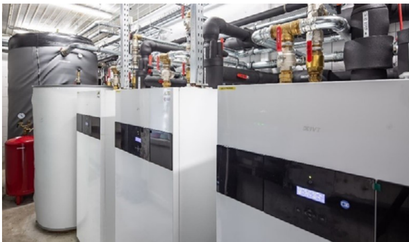
Obrázek 8: Strojovna tepelných čerpadel
