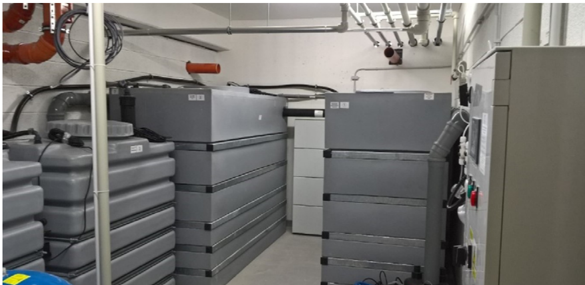
Obrázek 15: Technická místnost pro úpravu vody
