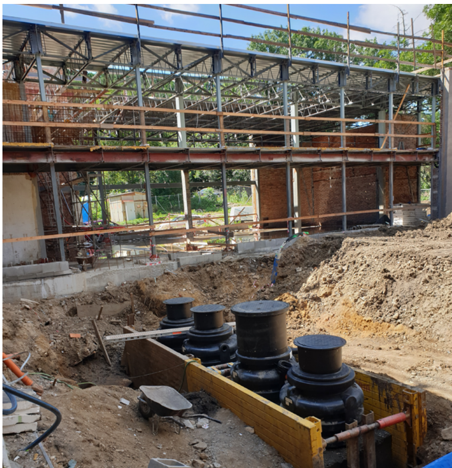
Obrázek 18: Instalace úpravný šedé vody
