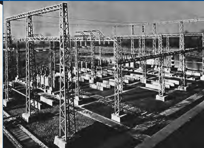
Nekrytá venkovská rozvodna na 110 000 voltů v Dluhonicích
