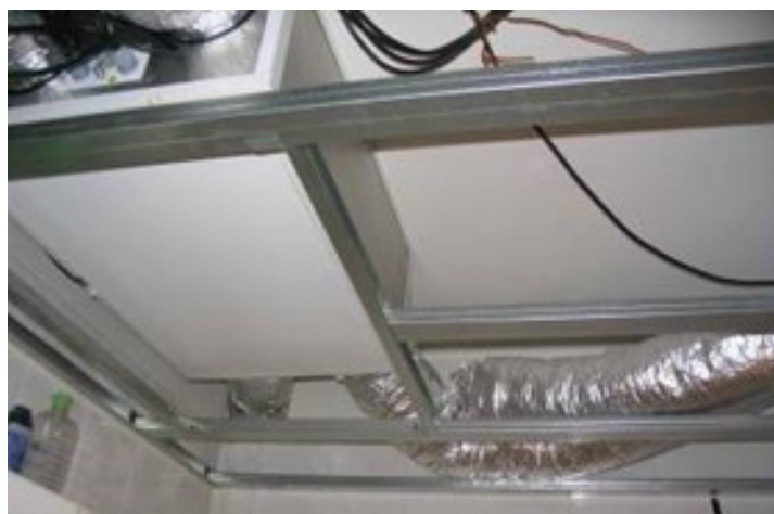
Obrázek 16 - Příklad decentrálního větrání – zavěšená podstrovní jednotka před jejím zakrytím sádrokartonem, zajišťující individuální větrání bytu
