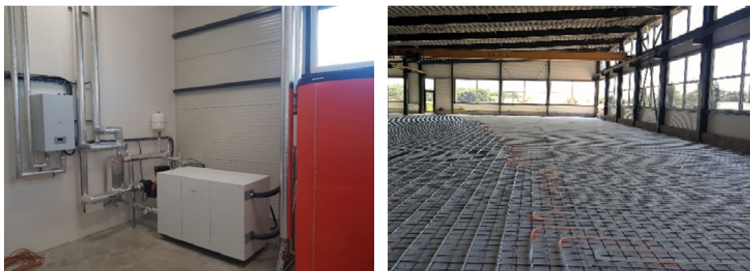
Obrázek 12: Příklad technologie s použitím tepelného čerpadla země/voda (konkrétně IVT GEO G pro vytápění i chlazení objektu se sálavým plošným systémem LoWaTec), Zdroj: GT Energy
