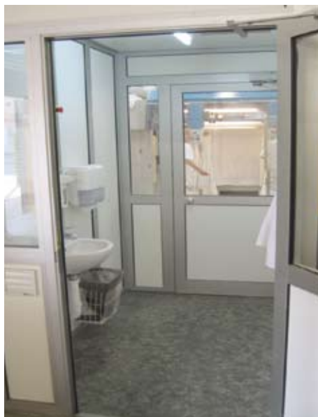
Součástí dodávky byla i stavební část (přechod mezi špinavou a čistou částí prádelny)
