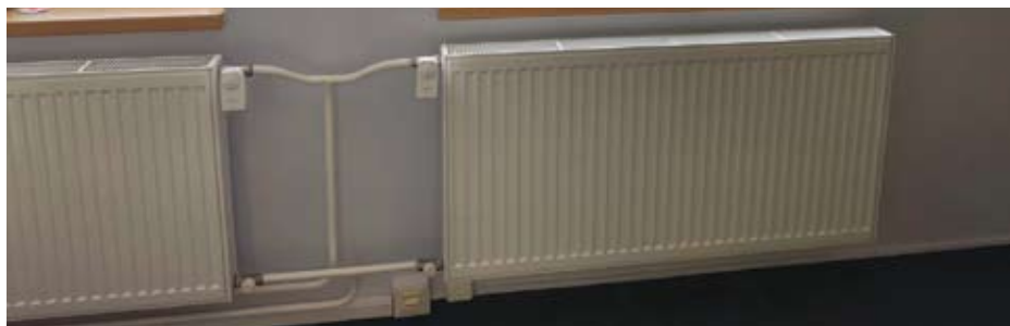
Pohled na radiátory s ventily a s hlavicemi systému IRC
