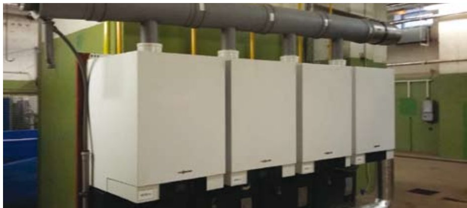
Plynová kotelna tvořená kaskádou čtyř plynových kotlů
