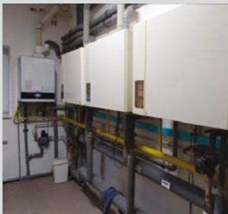
↑ Kondenzační plynové kotle - hlavní kotelna
