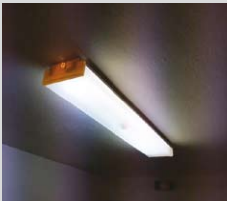
↑ Vnitřní zářivkové osvětlení
