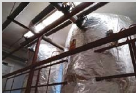
Obrázek 17: Kotelna č. 2 (1.PP budovy B - DDM chlapci)
