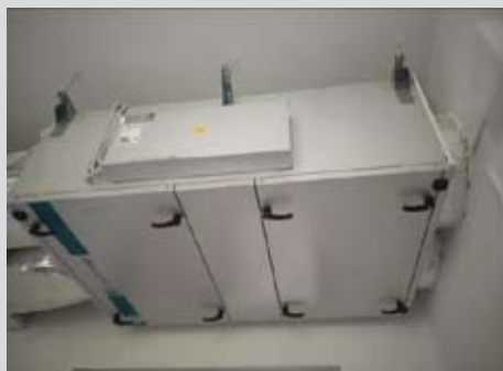
↑ VZT pro tělocvičnu
