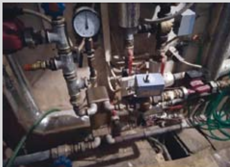
Obrázek 6: Objektová předávací stanice
