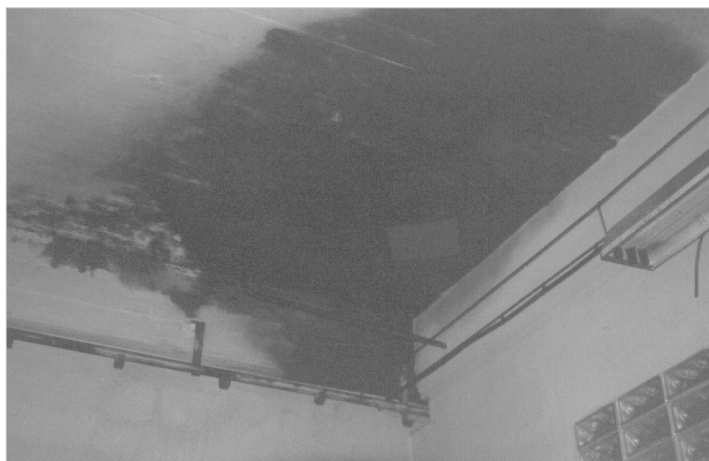
Obrázek 7 – Detail poškozené stropní konstrukce
