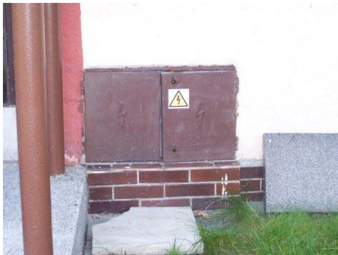
Obrázek 10-4 Hlavní domovní skříň objektu Krásnopolská č.p. 86.
