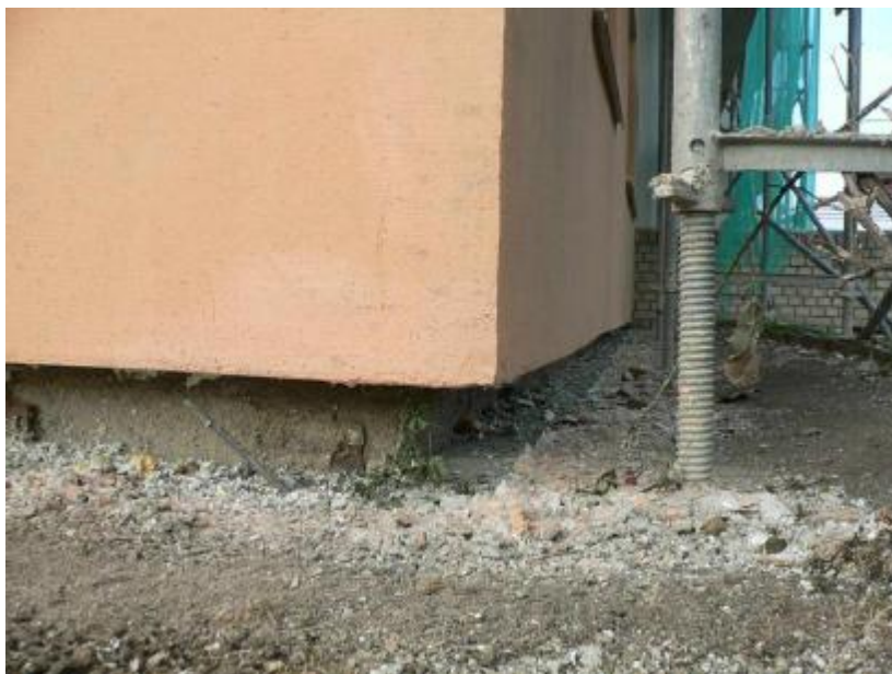
Obrázek 12: Špatně navržené zateplení
