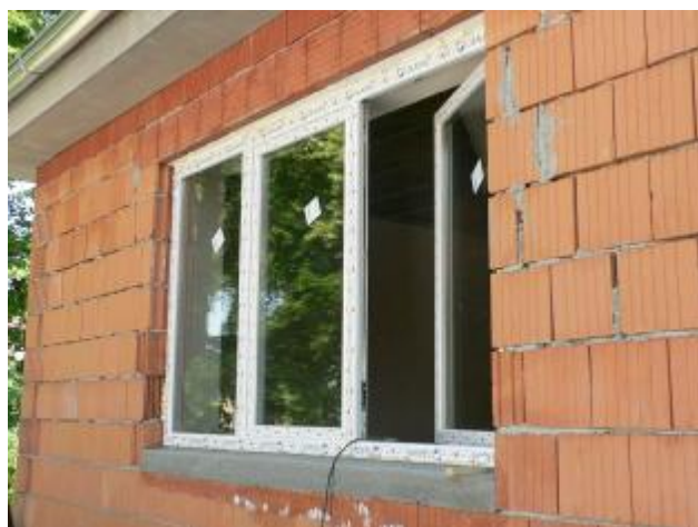
Obrázek 2: Výrazný tepelný most tvořený masivním podbetonováním okna
