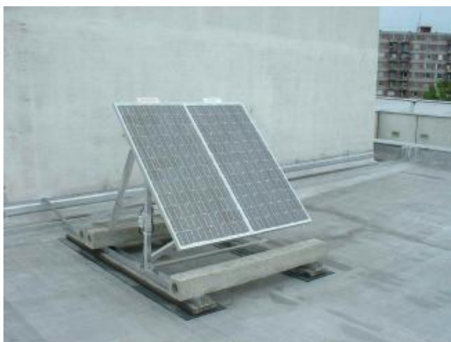
Obrázek 55: Fotovoltaický systém ve škole
