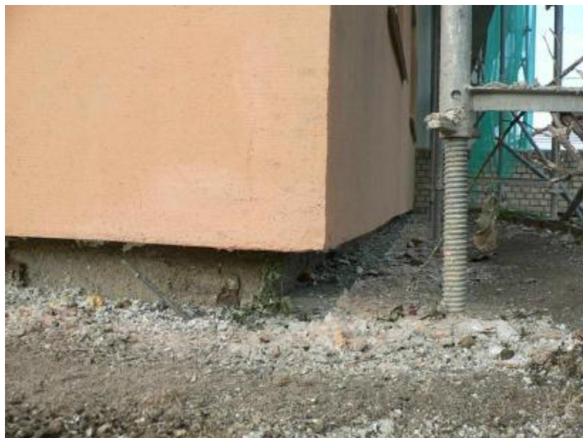
Obrázek 21: Špatně navržené zateplení
