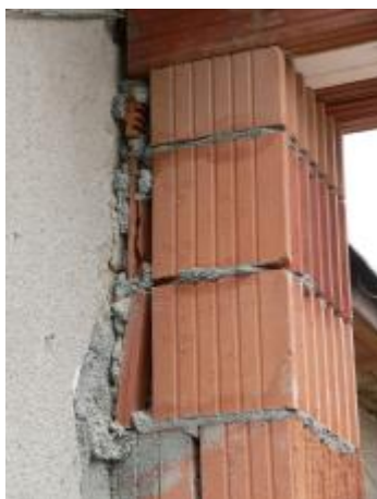
Obrázek 3: Tepelný most způsobený nedodržením technologie zdění
