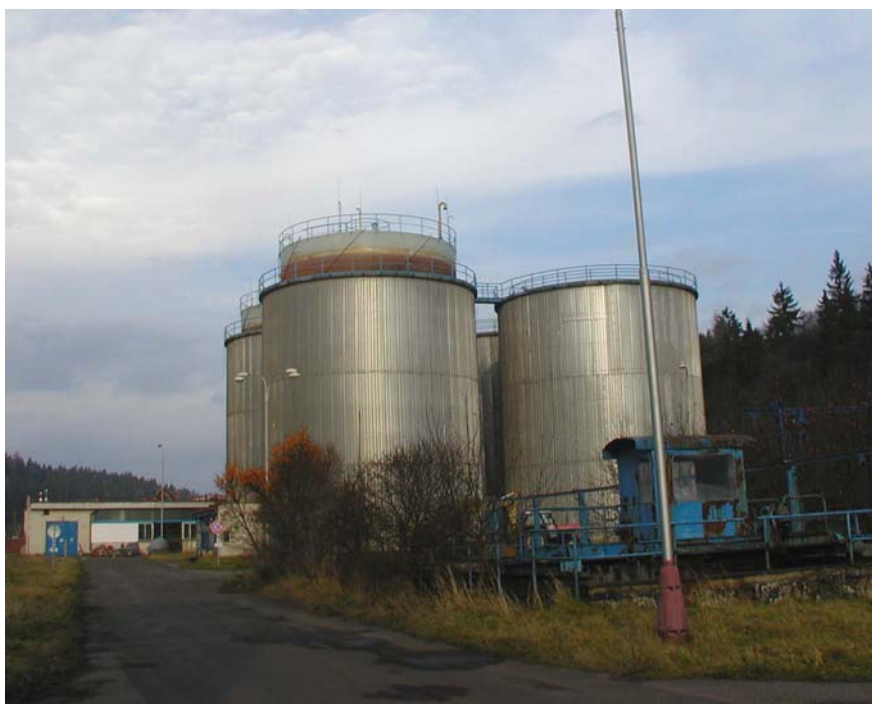
Vyhnívací nádrže se zvonovým uzávěrem, vytvářejícím proměnný akumulční prostor pro bioplyn (v pozadí vlevo kotelna s instalovanou KJ).
