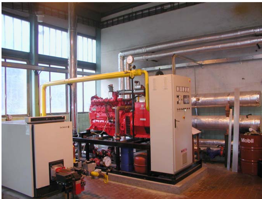
Kogenerační jednotka Motorgas NAG 70 a kotel De Dietrich GT 309
