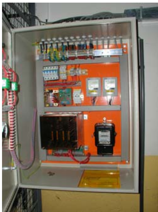
Pohled na elektrorozvaděč DPST
