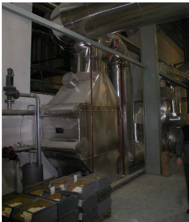
Rekuperační výměník u vypalovací pece vzduch - voda
