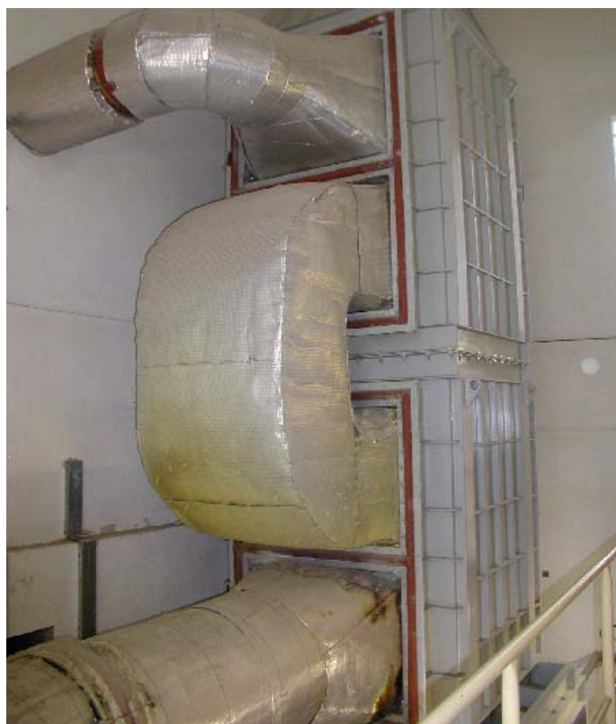
Výměník spaliny – odpyny
