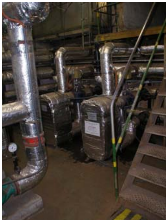
Pohled na část rekonstruované VS 02 s deskovými výměníky tepla
