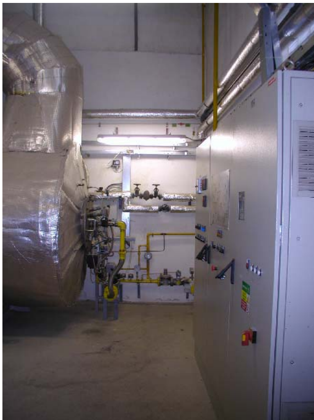
Boční pohled na čelo spalovací komory
