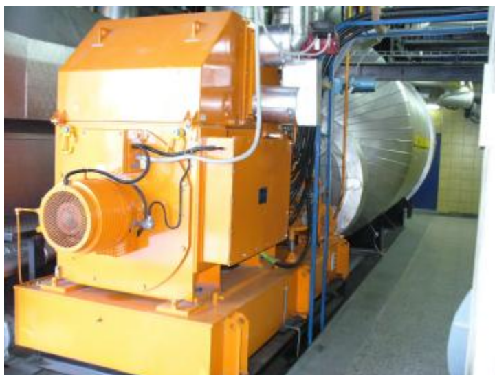
Obrázek č. 5.6.9 Pohled do reálného provozu strojovny ORC
