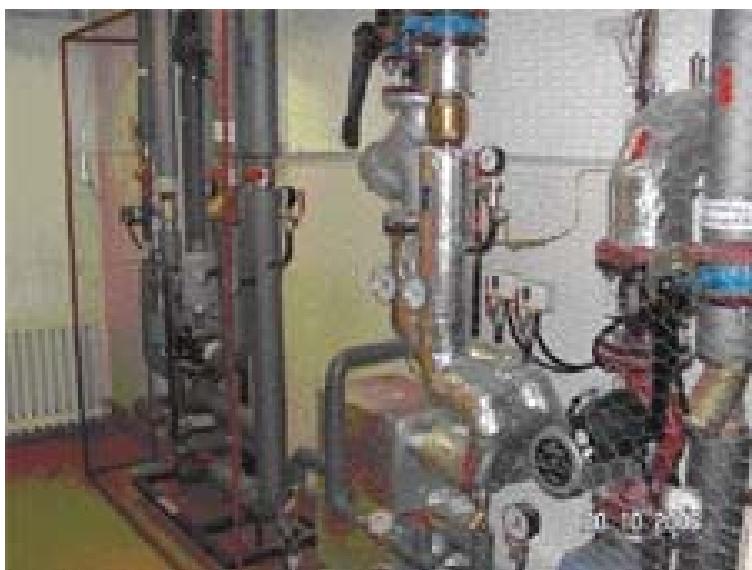
Detail strojovny ÚT
