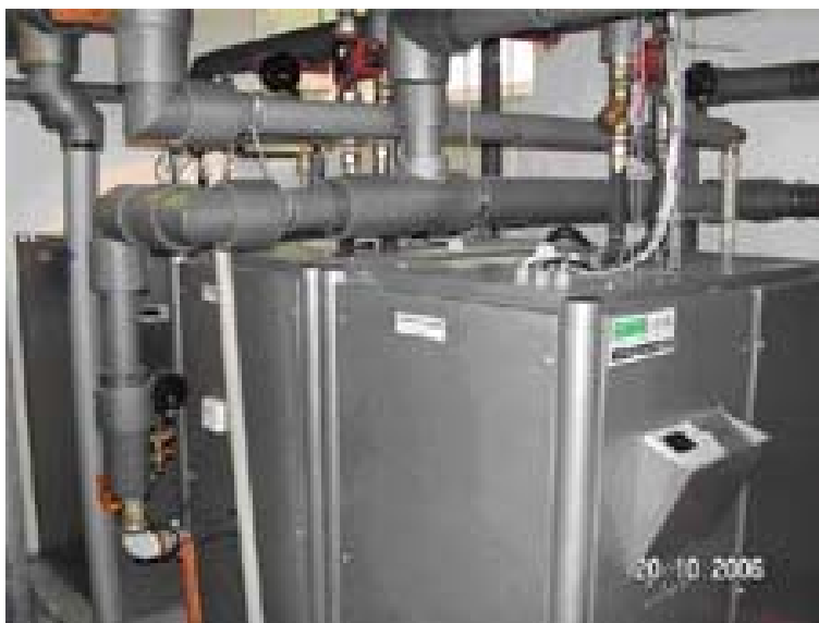
Kaskáda tepelných čerpadel
