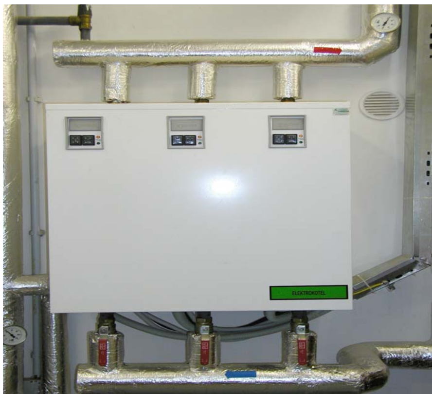
Elektrokotle ve zdrojových stanicích
