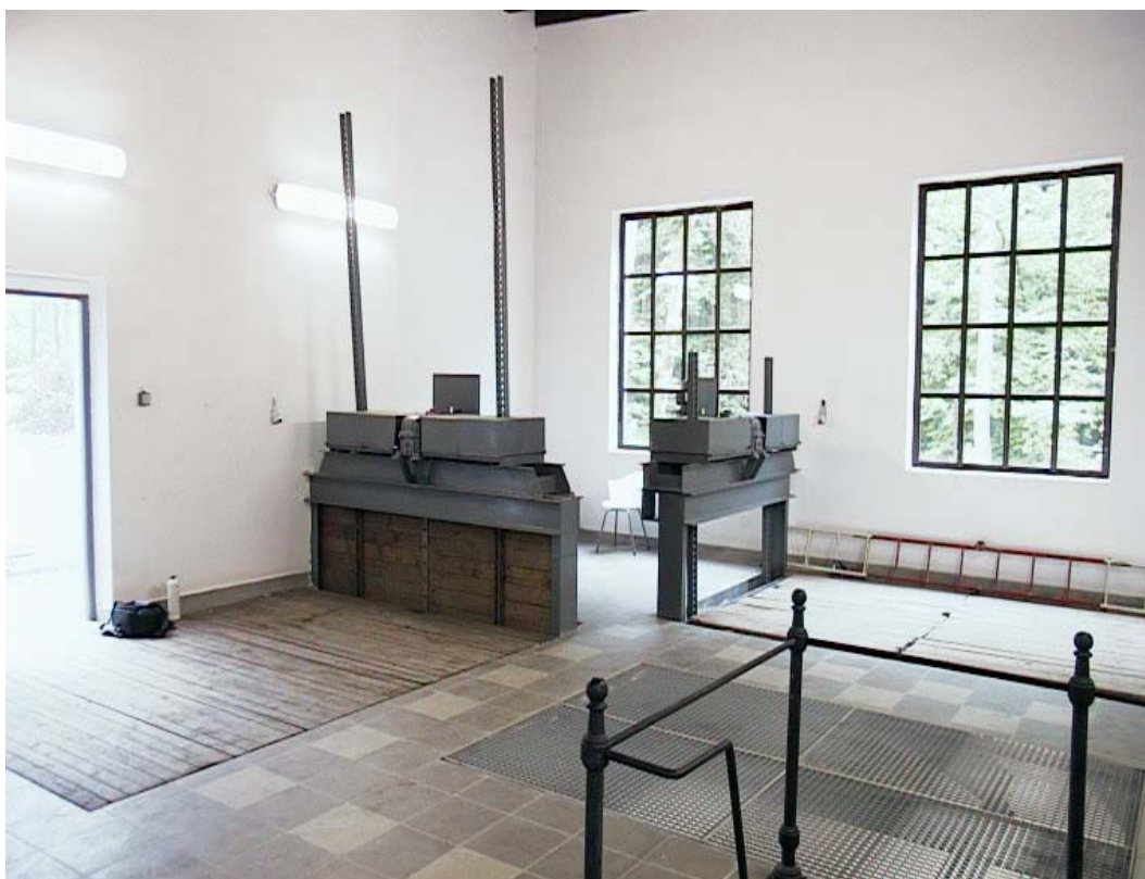
Prostor se stavidly a řídicí regulační jednotkou
