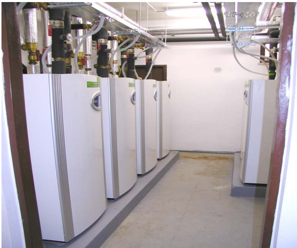
Zdrojová stanice č. 5
