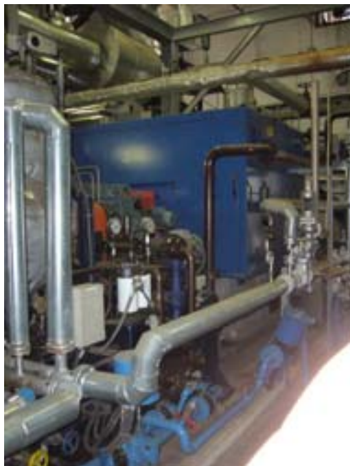
Turbosoustrojí – protitlak. část
