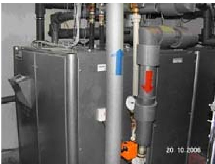
Jedno z tepelných čerpadel
