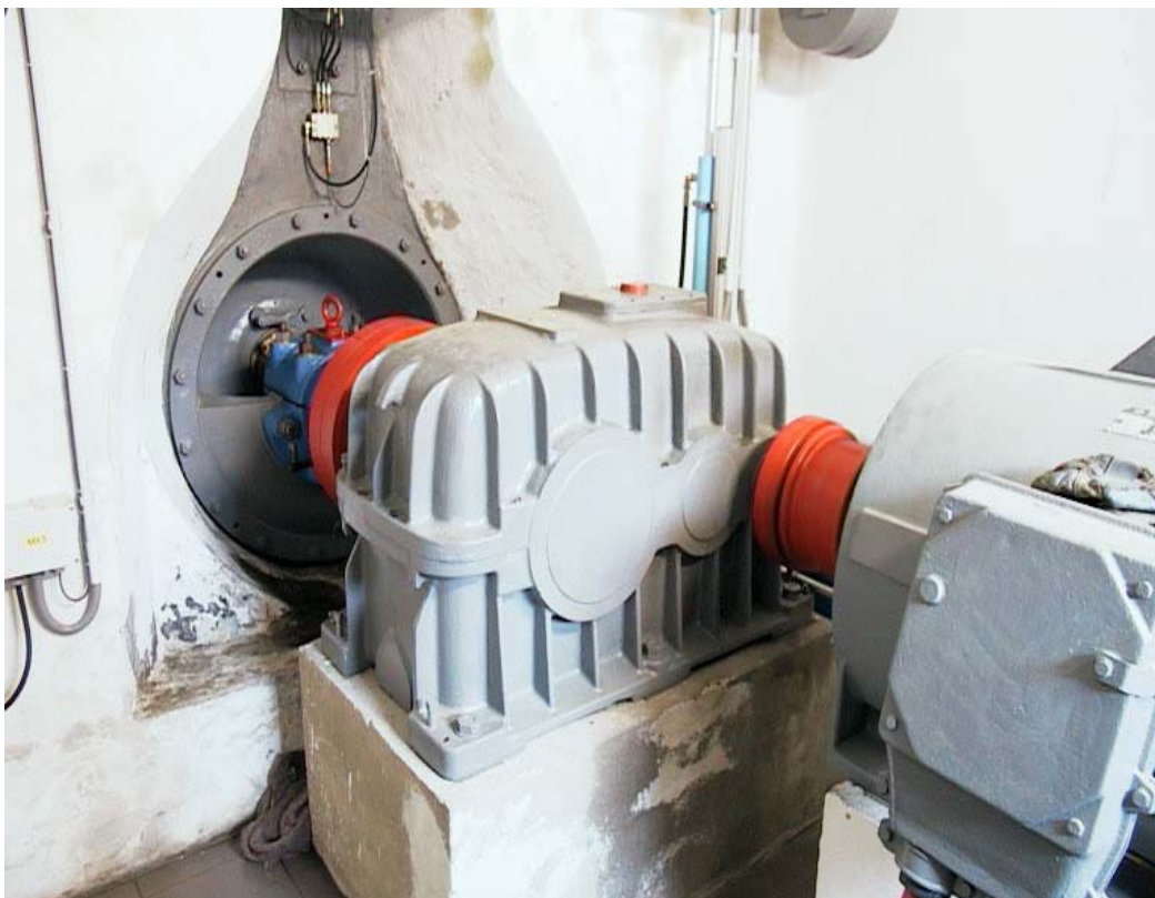
Detailní pohled na zařízení MVE – turbína, převodovka a generátor
