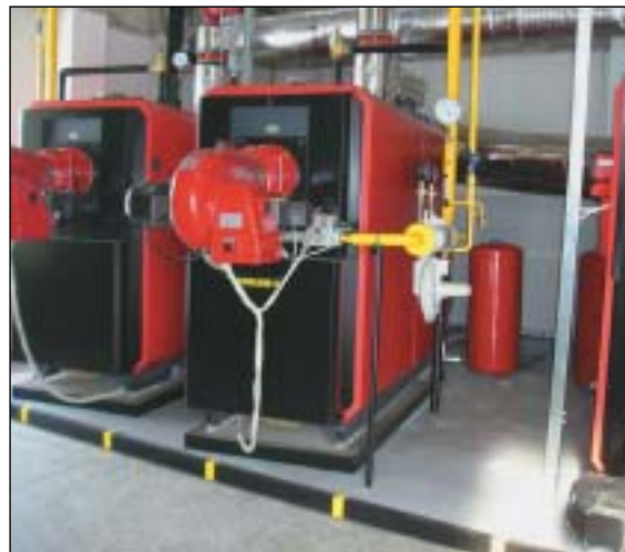
Nové kondenzační kotle Frohling Eurotwin 2000 K/1250
