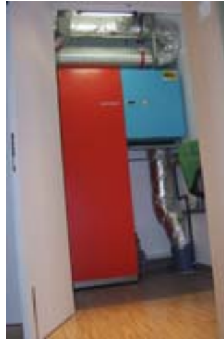
Abb.: Komfortlüftungsgerät mit hocheffizienter Wärmerückgewinnung und Kleinstwärmepumpe für Heizung und Warmwasser in der „Haustechnikzentrale“
