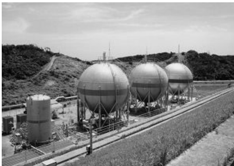
Obrázek 2: Skladování kapalného vodíku
